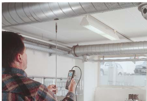
testo 416 při nastavování dodávaného vzduchu do kuchyně
