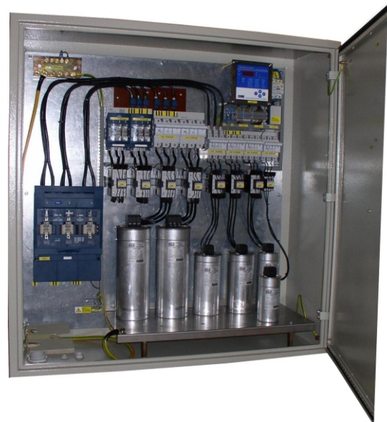
Rozvaděčová skříň KR1
