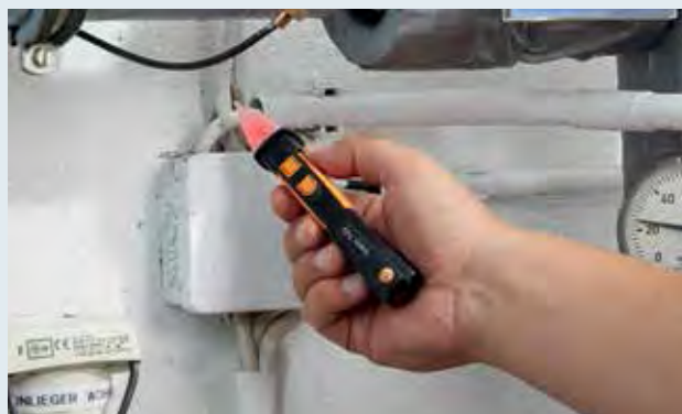
Bezkontaktní měření napětí na rozvodné skříni otopného systému s testo 745.
